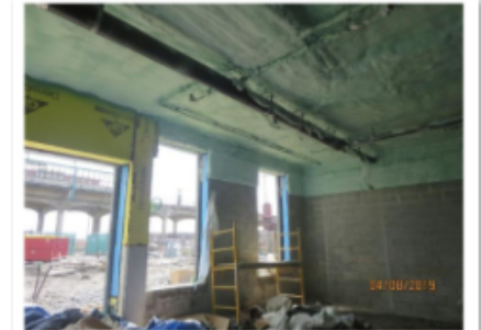
Garage Ceiling 03.JPG
