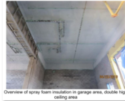
Garage Ceiling 02.JPG
