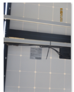
Carport PV 4.JPG
