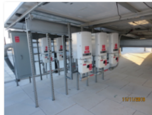
Roof PV 2.JPG
