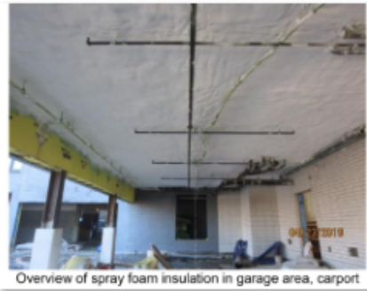
Garage Ceiling 01.JPG
