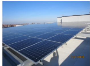
Roof PV 1.JPG
