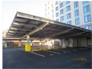
Carport PV 1.JPG
