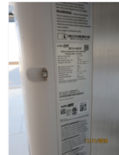
Roof PV 3.JPG
